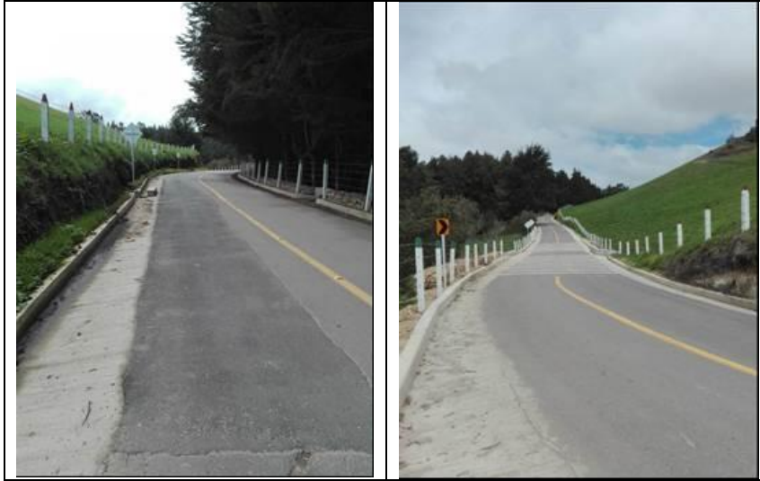
Foto 1 y 2. Carpeta asfáltica con deficiente acabado.
